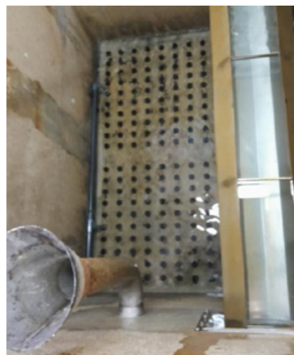
Réservoir charbons actifs nettoyé
